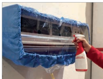
PULIZIA BATTERIA CON TELO DI PROTEZIONE APPLICATO
